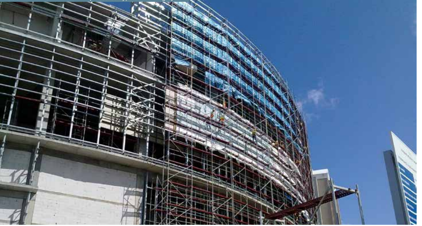
PROJE ADI : FENERBAHÇE ÜLKER ARENA GÜVENLİKLİ İSKELE SİSTEMİ / Secured Type Scaffolding System
